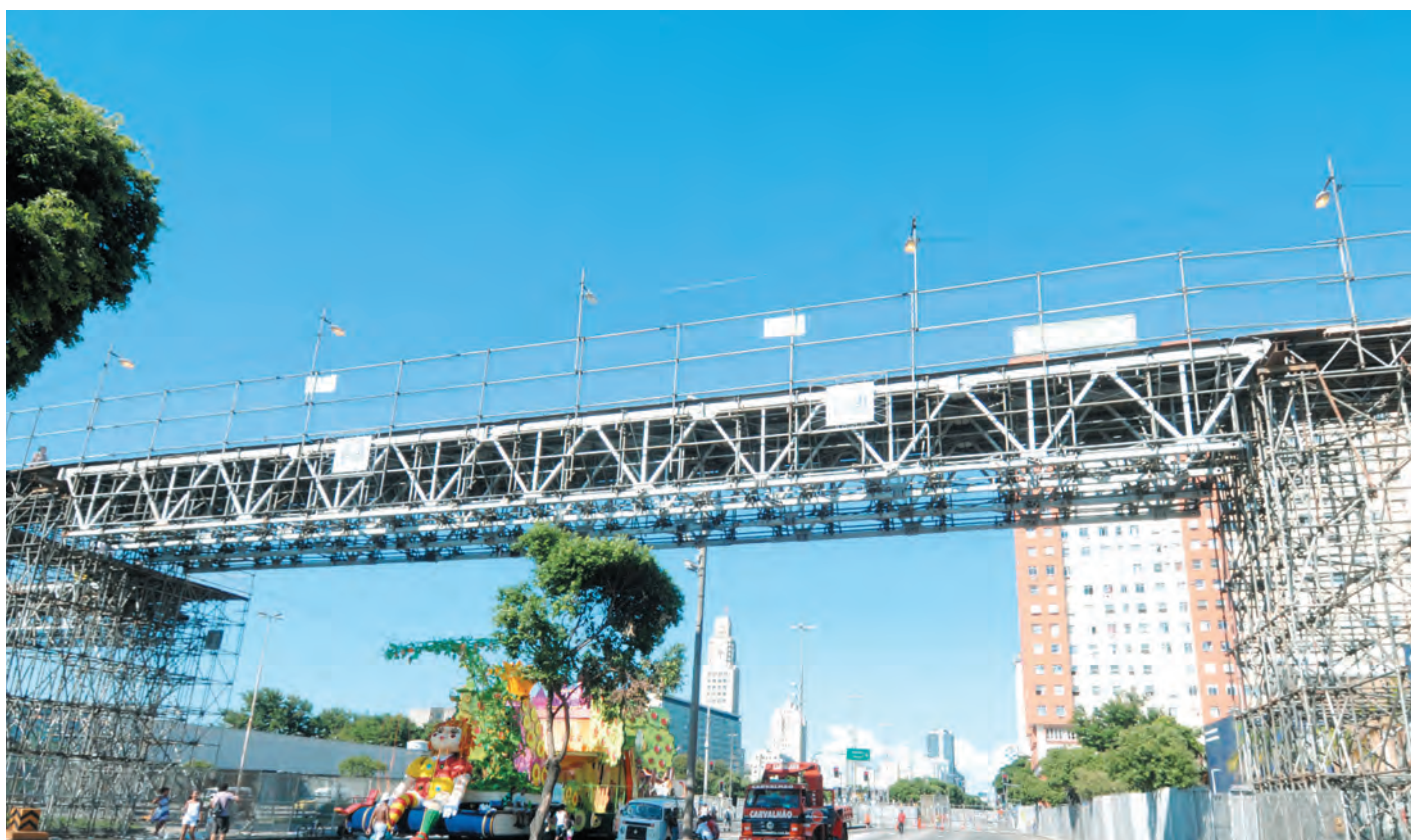
A passarela facilita o deslocamento de componentes na Concentração
